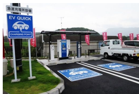
(整備イメージ 1) 道の駅なかつ EV 充電施設
