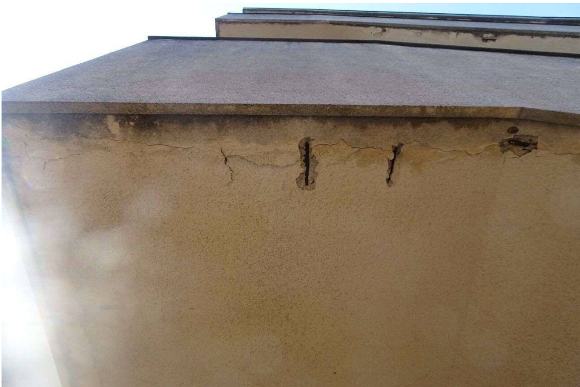
【写真9：鉄筋腐食によるひびわれ】外部階段より
