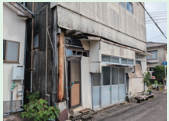
住宅隣接の崩壊廃屋
