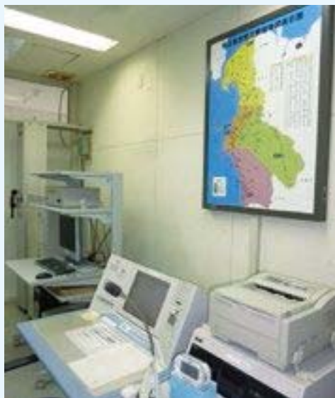
市役所の防災行政無線放送設備
