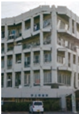
熊本宇土市役所は 崩壊寸前に
