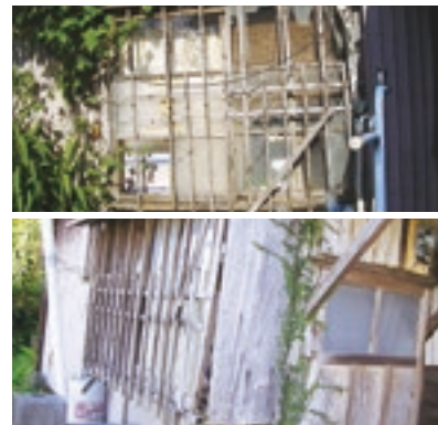
老朽化した市営住宅 (10月10日撮影)
