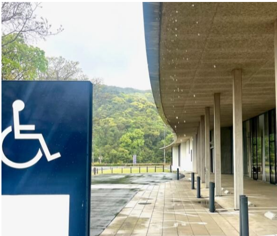
障害者用駐車場- 雨だれの状況
