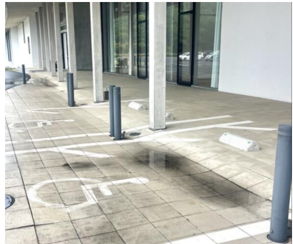
障害者用駐車場- 路面陥没とポール
