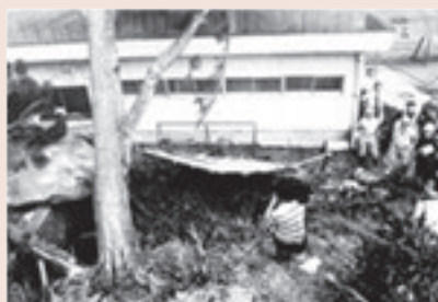
△大川小では落石と体育館が破損
