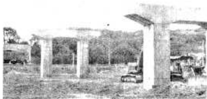
国道5号と環状本バイパスも全線開通へ向け急ピッチで工事が進む(鶴田の橋脚現場)
