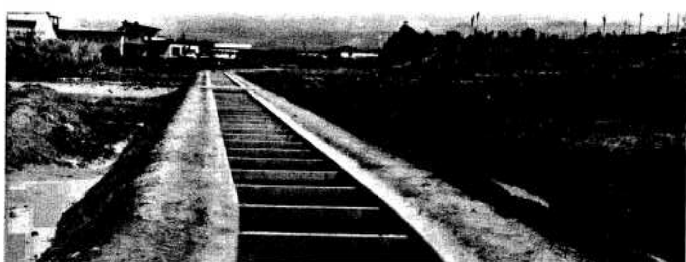
赤瀬川排水路…赤瀬川地区民念願の排水路。延長1,320m、工事費1億540万円
