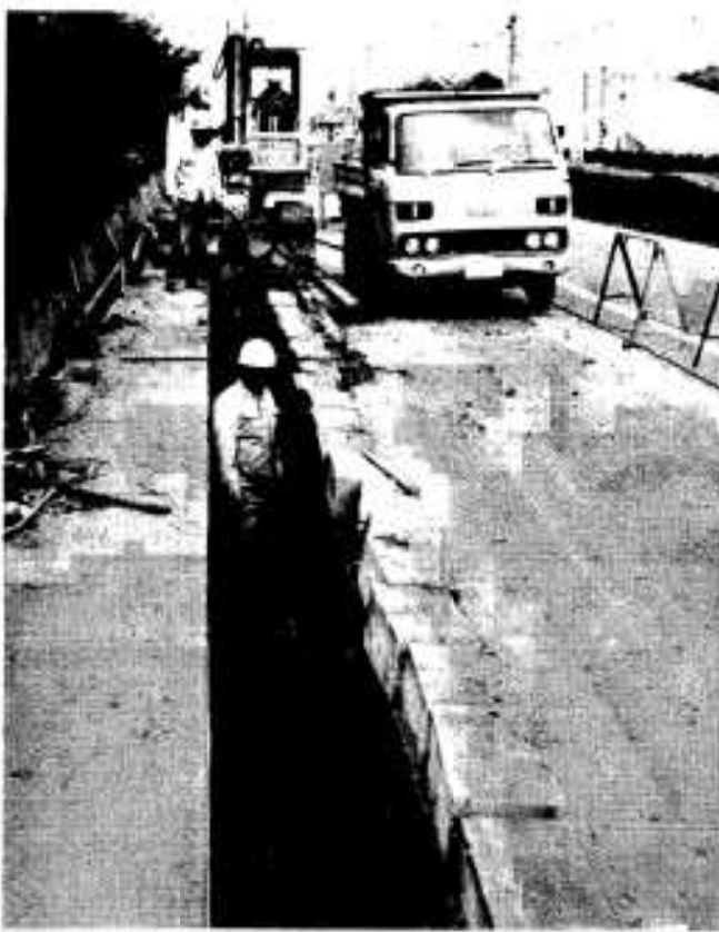
濁、高之口配水管布設…古くなった濁地区延長2,298mの配水管の布設替。4,780万円の事業費で完了。
