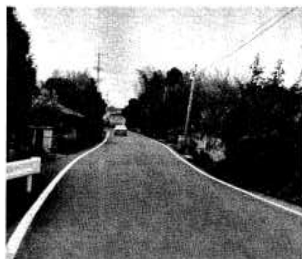
赤瀬川本線舗装…県道阿久根、東郷線大曲から牧内四文字まで3.2キロをきれいに舗装。
