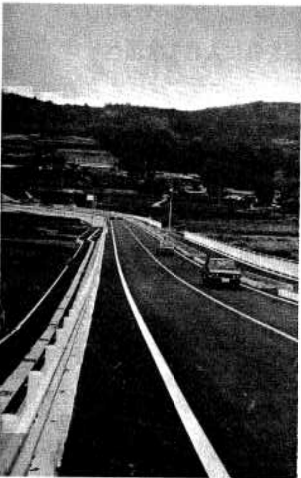
▶普及と進む都市計画、大丸、遠見ヶ丘線の工事 ▲臨本バイパスも一部使用が開始され、臨本地区の交通混雑が解消された
