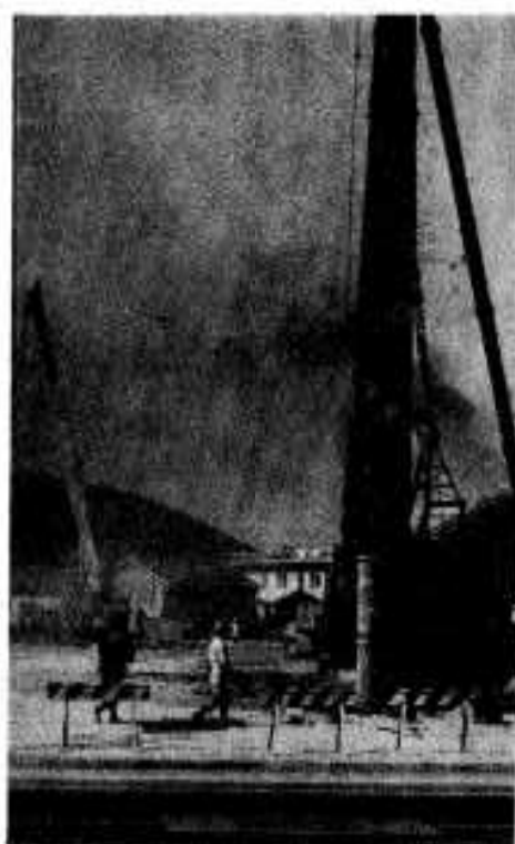
昨年十一月には大型スーパー だいわが新築工事に着手
