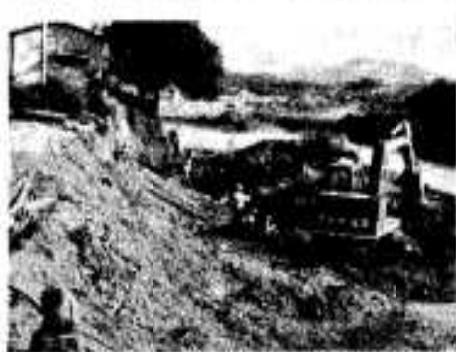
高松川災害復旧も急ピッチで進められている
