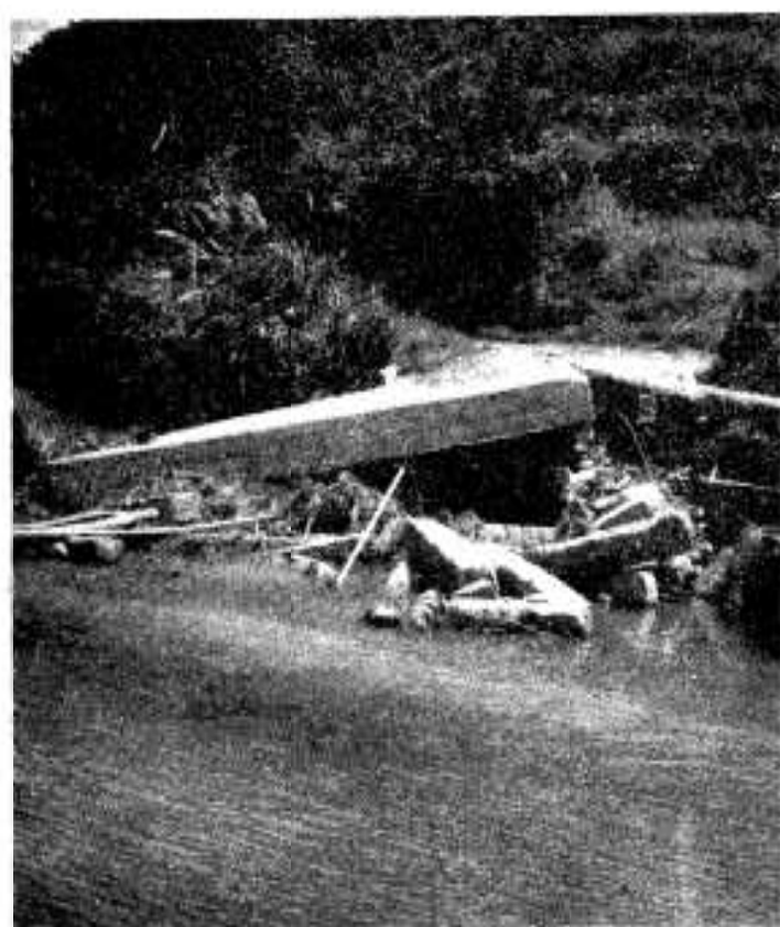
△橋りょうも流失(大川尻無地)
