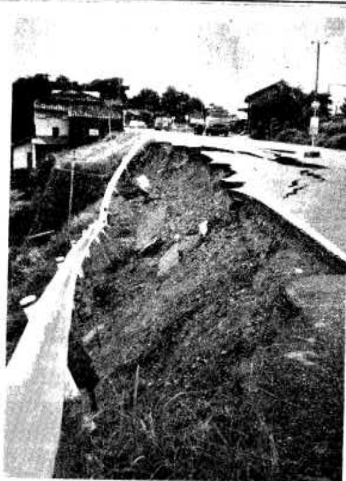
△ 国道3号線（牛之浜駅前付近）の崖くずれ
