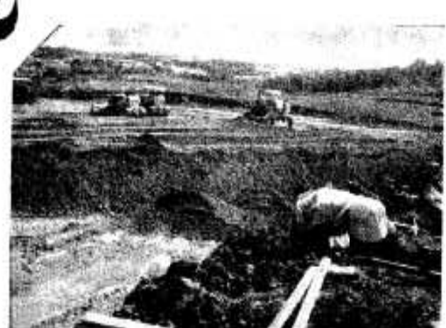
総合グラウンドの敷地造成がはじまり、毎日ブルドーザーがうなりをあげています。敷地は五万二平方材、四十七年度までには完成します
