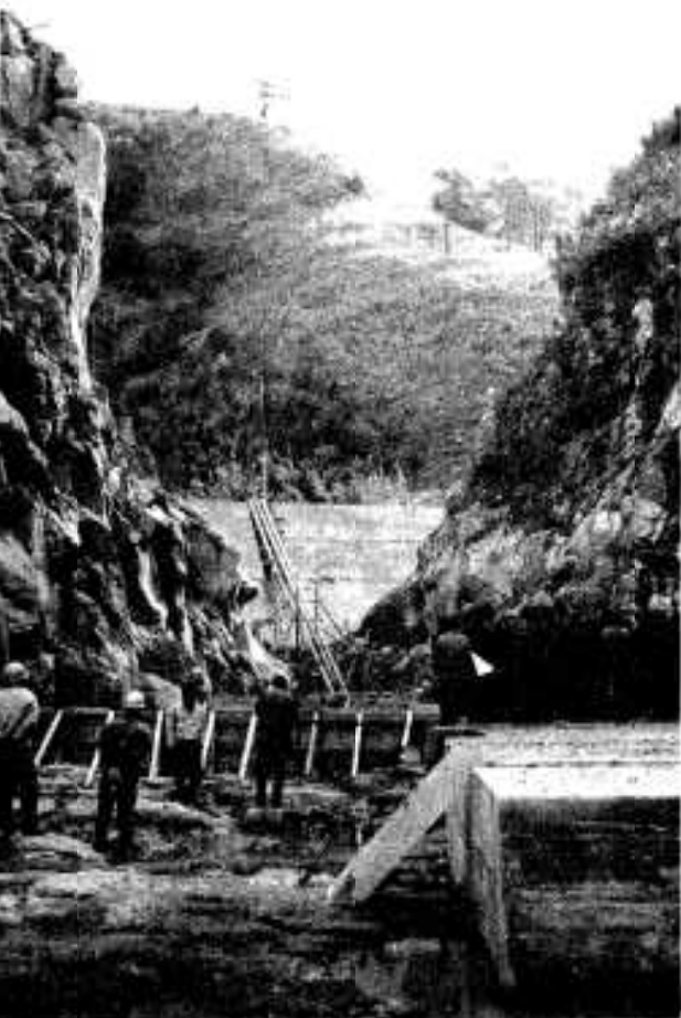
高松川もトンネルで流れをかえ、川床が現われましたここに防災ダムができると上流に人工湖が出現します。
