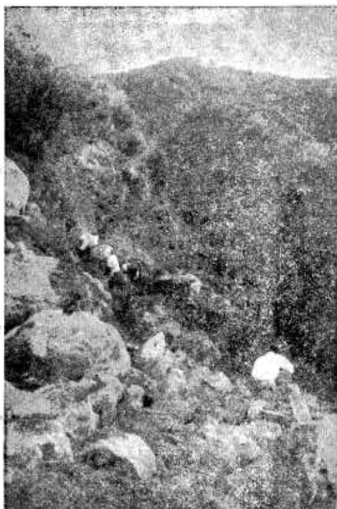
谷間をぬつて工事は進められ、発破のこう音があたりにこだましています。
