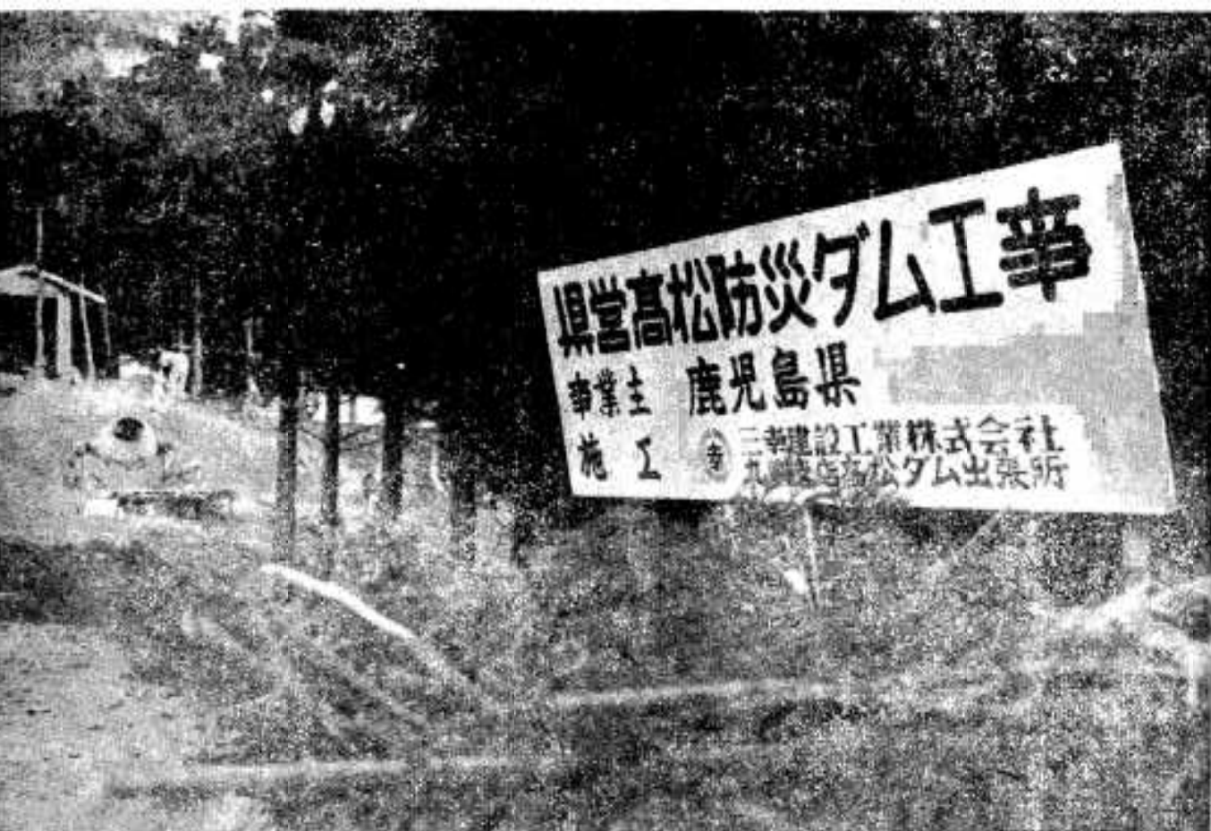
高松川防災ダムの建設工事も始まりました。まず、資材を運ぶとりつけ道路の建設が進められています。
