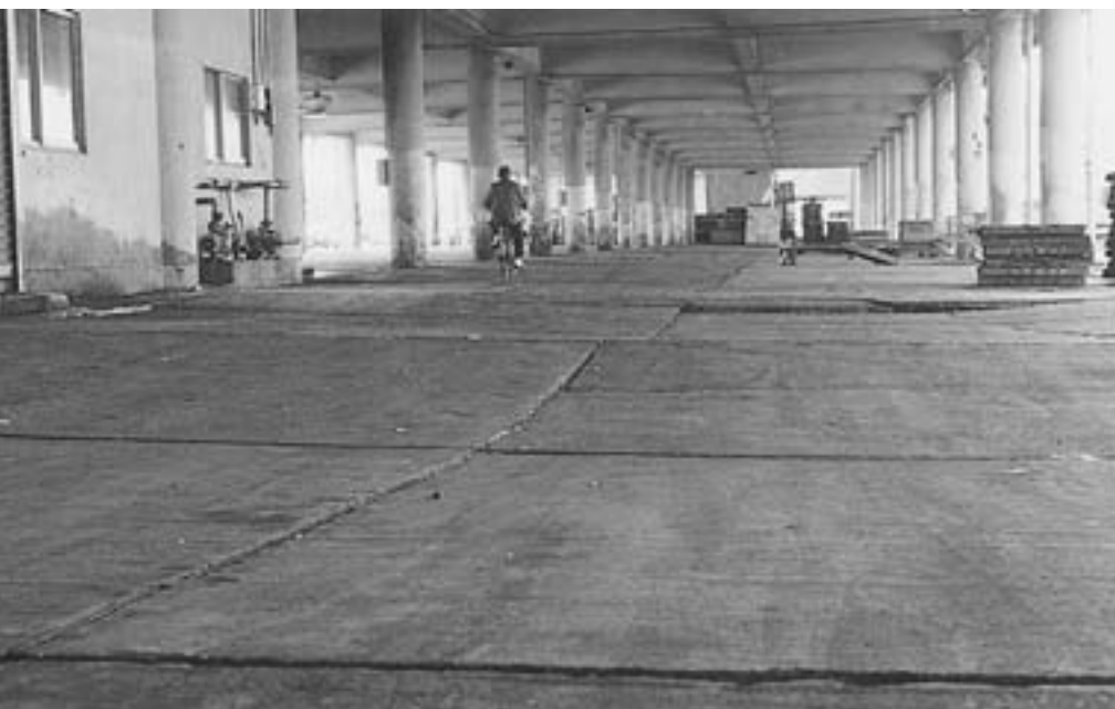
地震で大きな被害を受けた阿久根漁港（平成9年3月26日 地震発生直後撮影）
