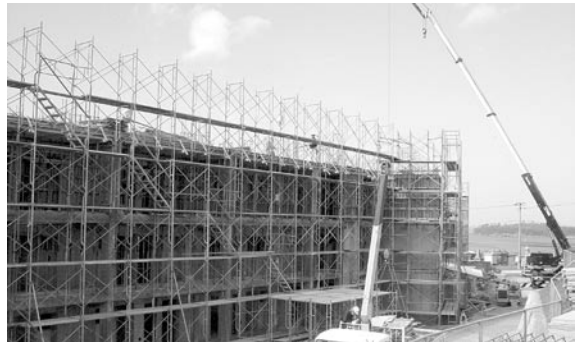
平成17年4月から入居開始に向けて順調に建設工事が進む寺山団地。
