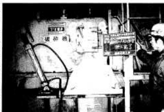
不燃物処理の“心臓部”である破砕機など更新
