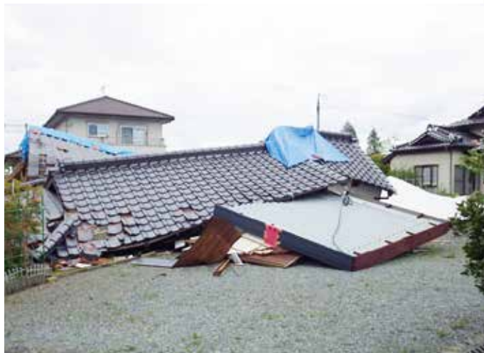
地震により倒壊した民家（宇城市中心部）
