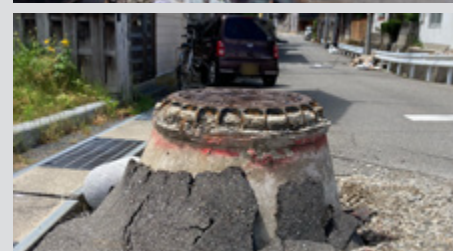
◀地震により大きく隆起したマンホール
