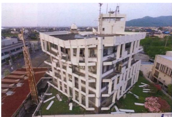
被災した宇土市役所
